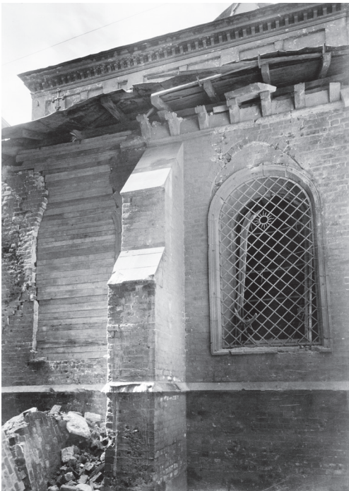
Kraków, Katedra na Wawelu. Widok wschodniej elewacji kaplicy pw. Narodzenia NMP, uszkodzonej w czasie II wojny światowej i zabezpieczonej deskami
